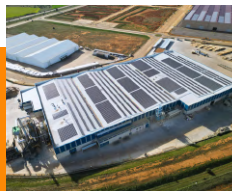
INDUSTRIAL ROOFTOP LOSÁN
